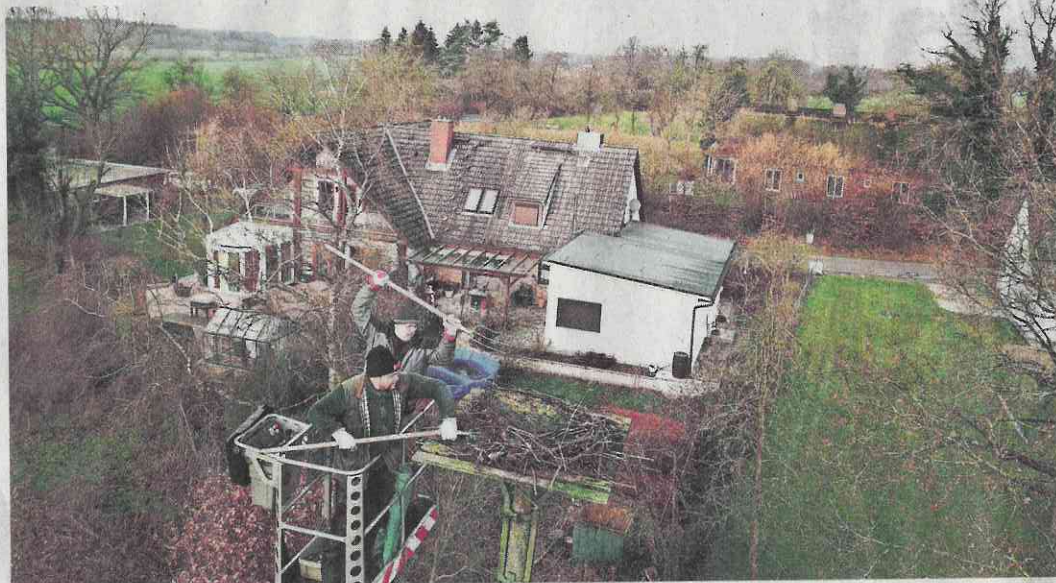
Aus einem Hubsteiger heraus wird am Teich in Kollow die Nistgelegenheit für Störche auf einem Mast erneuert.
